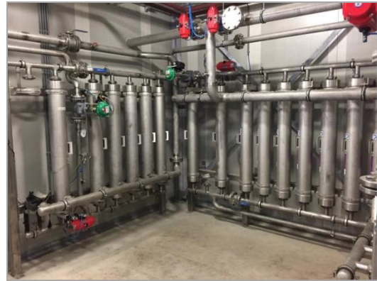
Photographie 17 : Système d'épuration membranaire (Source : Biogas Plus)
