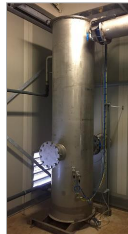
Photographie 15 : Colonne de lavage à l'eau (Source : Biogas Plus)
